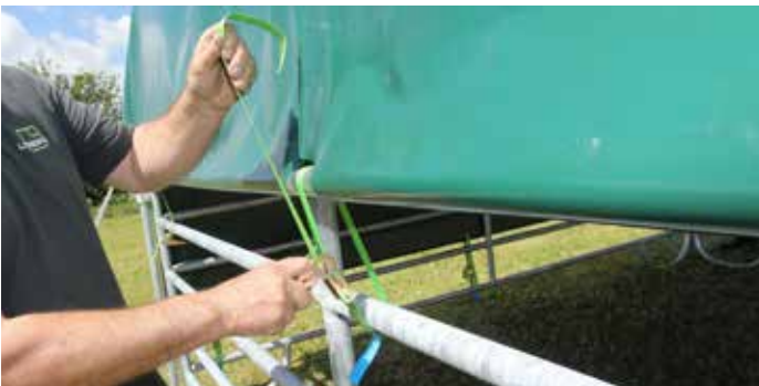
Schritt 24: Die Dachfolie mittels Abspanngurte an der dritten Querstrebe von oben am Panel fixieren. Die Dachfolie kräftig anziehen, die Folie muss bei Draufschlagen wie eine Trommel klingen. Das verhindert Bewegung der Folie bei Wind und somit das Durchscheuern.
