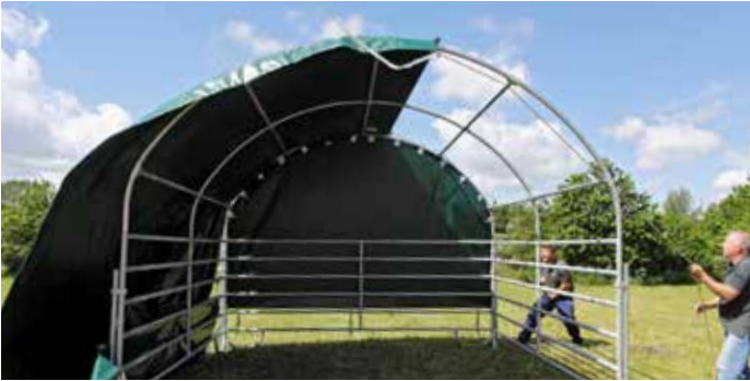
Schritt 22: Mittels Seil wird die Dachfolie von der gegenüberliegenden Seite über die Dachkonstruktion gezogen.
